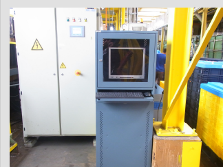
Pc-Terminal an der Hartchromanlage
