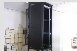
Zweiter Serverschrank im Aufbau
