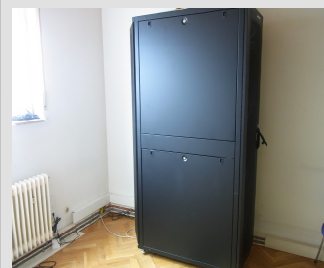
Serverschrank im Aufbau
